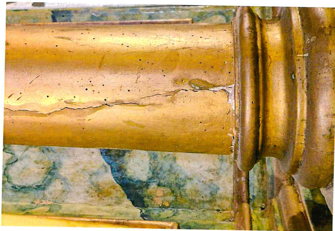
Fot.11 Dolny fragment kolumny z widocznymi ubytkami i pęknięciem zaprawy. Zwraca uwagę zaawansowany atak makrobiologiczny drewna, żerowiska są aktywne.
