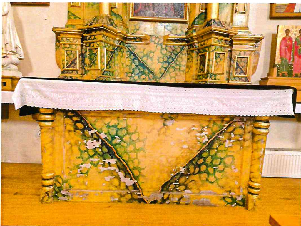
Fot.5 Podstawa i predella ołtarza przemalowane nieestetyczną marmoryzacją i pomalowane złotą farbą. Drewno detali zdegradowane przez owady w nim żerujące.
