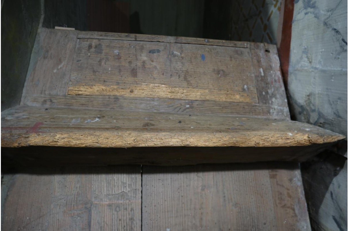
Fot. 7. Tyrawa Solna, kościół pw. Św. Piotra i Pawła, nawa, ambona, schody (fragm.), 1 poł. XIX w. Stan przed konserwacją. Widoczne znaczne uszkodzenia stopni schodów ambony. Fot. M. Ptasińska
