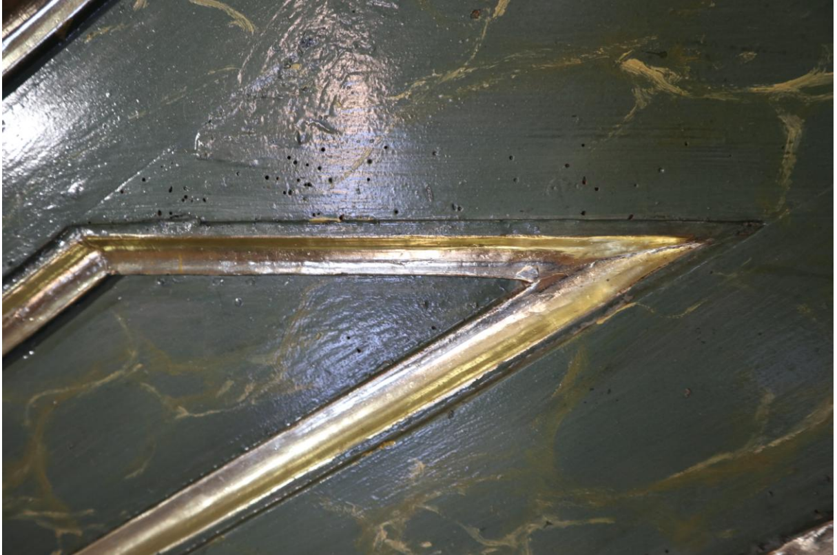
Fot. 6. Tyrawa Solna, kościół pw. Św. Piotra i Pawła, nawa, ambona, balustrada (fragm.), 1 poł. XIX w. Stan przed konserwacją. Widoczne otwory świadczące o niszczącej działalności drewnojadów. Fot. M. Ptasieńska
