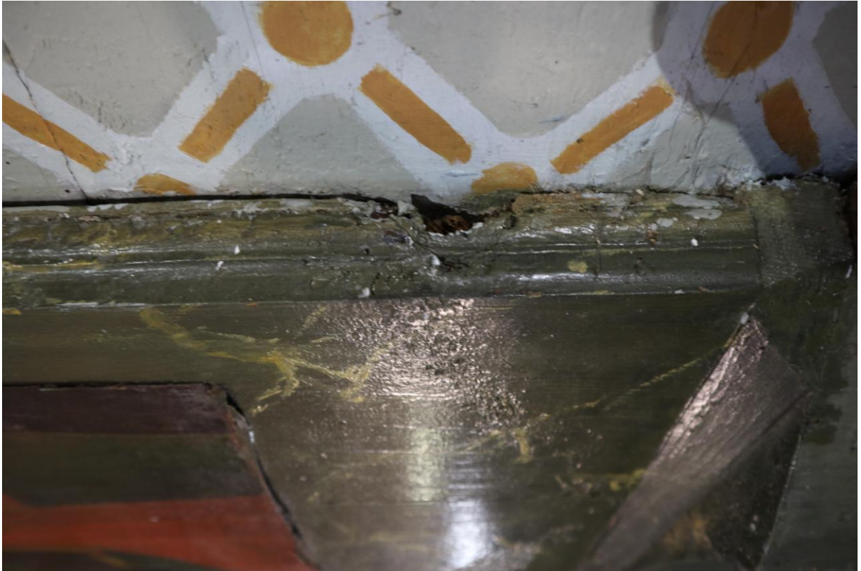
Fot. 10. Tyrawa Solna, kościół pw. Św. Piotra i Pawła, nawa, ambona (fragm.), 1 poł. XIX w. Stan przed konserwacją. Widoczne ubytki drewnianej struktury. Fot. M. Ptańska
