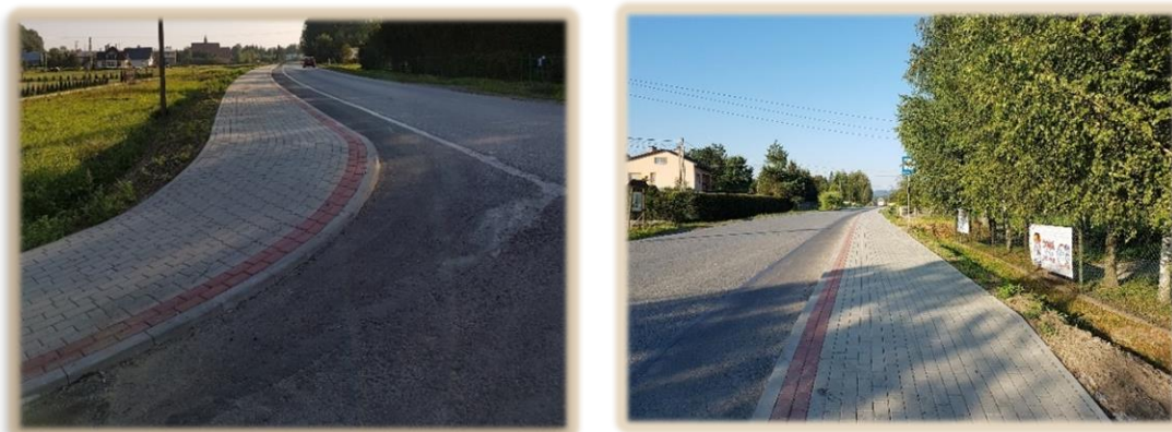
Budowa chodnika z przy drodze powiatowej nr 2212R Sanok-Bukowsko w m. Sanoczek
